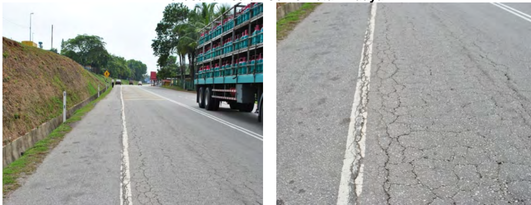
Gambar 2.6 Kerosakan Jalan Jenis Retak Buaya
