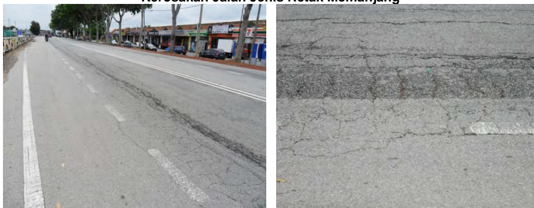
Gambar 2.7 Kerosakan Jalan Jenis Retak Memanjang
