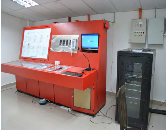
Gambar 4.15 Keadaan Di Dalam Bilik Kawalan Utama – Sistem Kawalan Kebakaran
