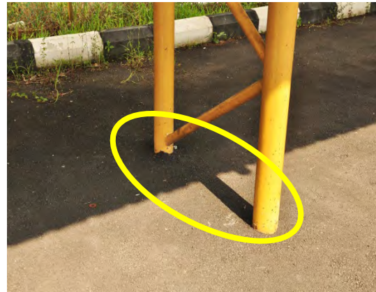
Gambar 3.20 Tiang Yang Tidak Mempunyai Footing
