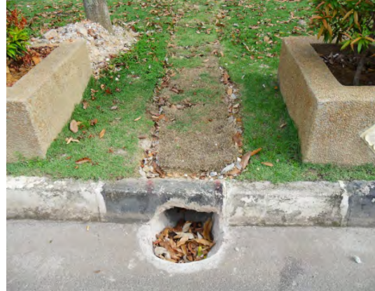
Gambar 2.19 Saluran Air Di Kerb Yang Telah Dibaiki
