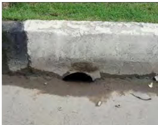
Gambar 2.17 Saluran Air Yang Sempit Pada Kerb
