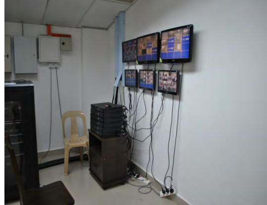
Gambar 4.16 Keadaan Di Dalam Bilik Kawalan Utama – Skrin Kawalan Kamera Litar Tertutup
