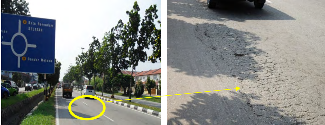
Gambar 2.9 Kerosakan Jalan Jenis Retak Dan Mendap
