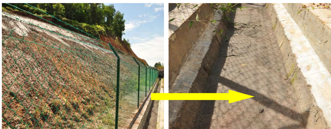
Gambar 3.21 Keadaan Tebing Dan Longkang Yang Dipenuhi Lumpur
