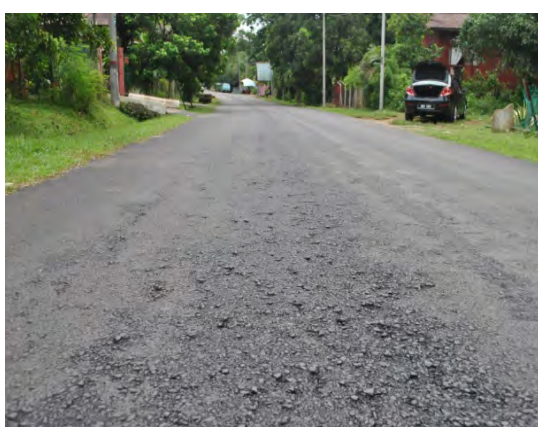
Gambar 2.5 Penurapan Jalan Yang Tidak Rata
